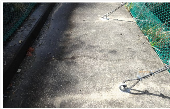
STA.0+060 1소단배수로 균열
