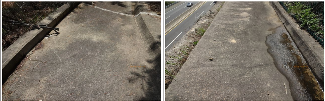
19.40K 1소단배수로 균열
