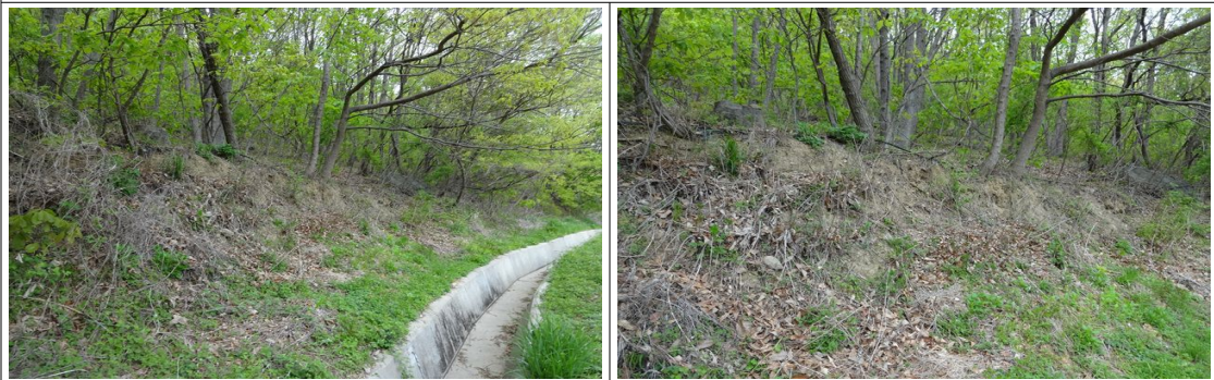
STA.0-20 자연사면 표층유실
