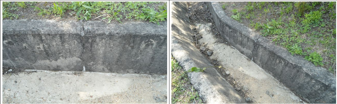
STA.0+70 1단 배수로 균열0.5/0.5
