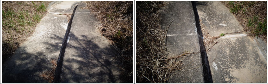
46.72K 2소단배수로 균열
