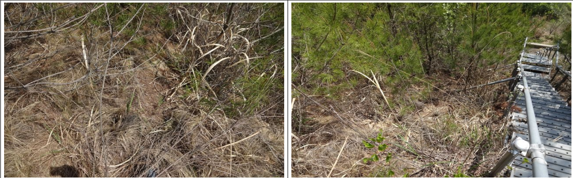
우측사면 STA.38+550 5~6단 표층유실
