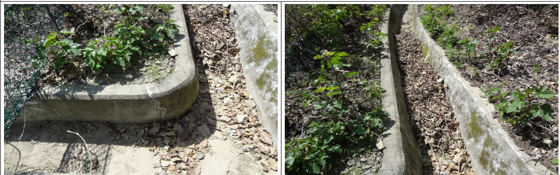
71.00K 산마루측구 토사퇴적, 균열
