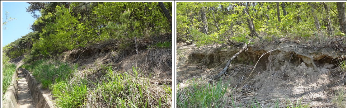
STA.0+80 자연사면 표층유실
