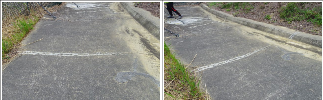
12.68K 1소단배수로 균열 0.3
