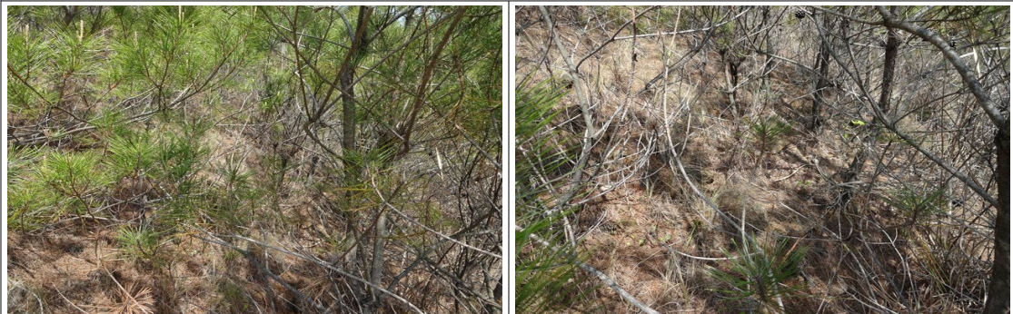
우측사면 STA.38+560 7~8단 표층유실
