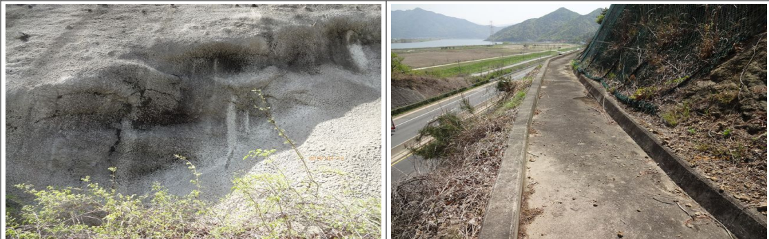
19.45K 1단 슛크리트 균열
