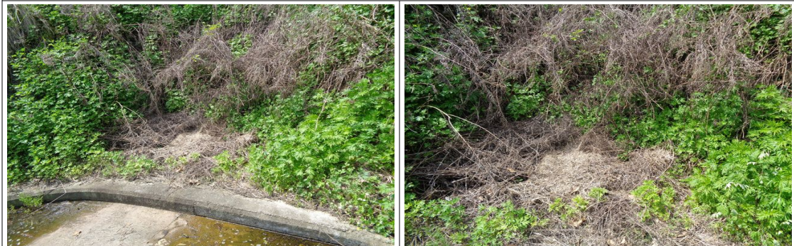
STA.60+270 2단 녹생토유실 2.0*2.0
