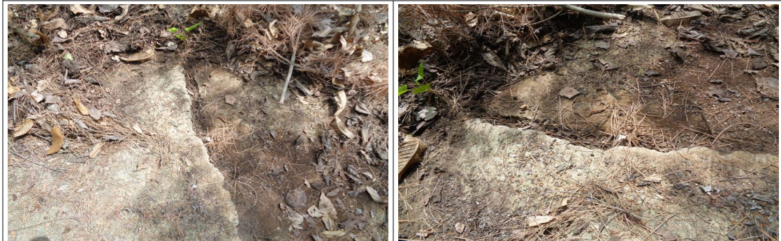
78.32K 1소단배수로 파손
