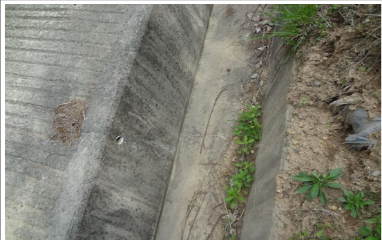
78.10K 산마루측구 균열
