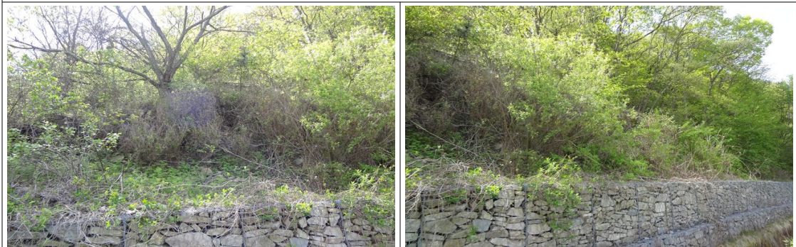
STA.0-15 자연사면 유실우려
