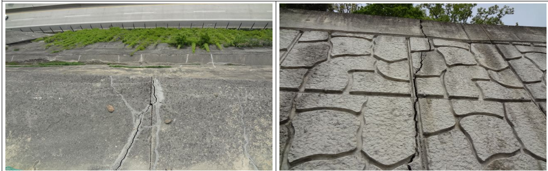
76.45~76.53K 3단 옹벽 균열
