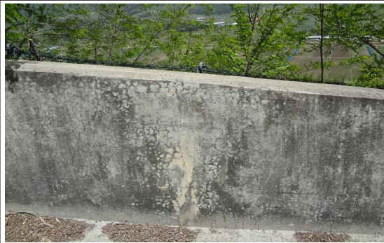
66.16K 배후도로 방호벽 균열
