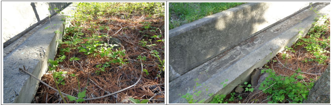
STA.58+645 1단 측구 뒷채움 토사유실
