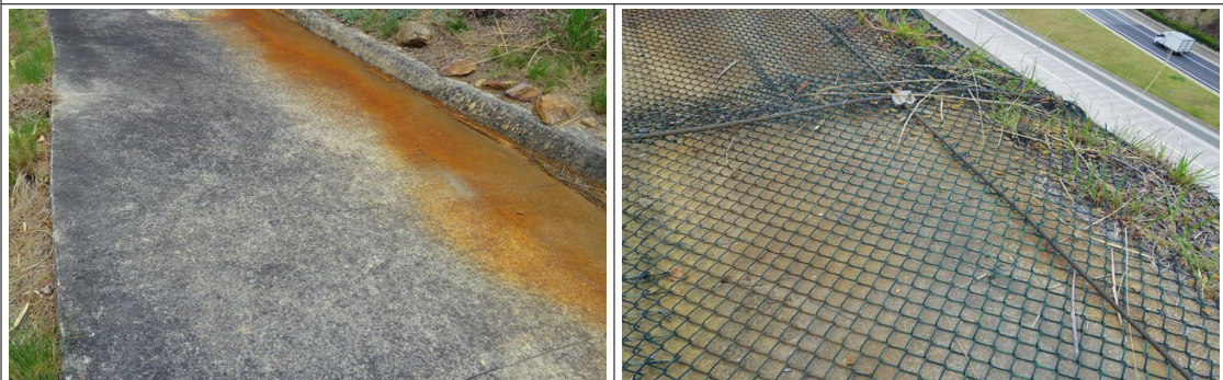
10.75K 2소단배수로 균열
