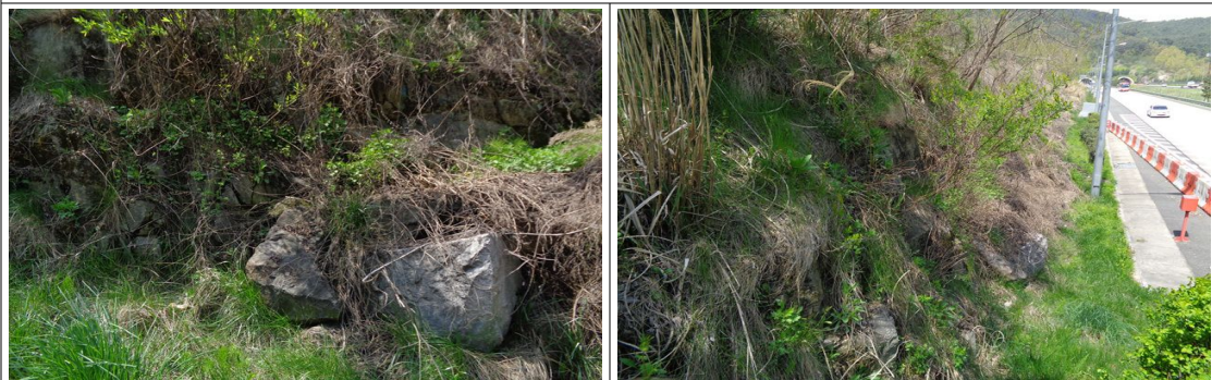
STA.41.375 1단 암노출
