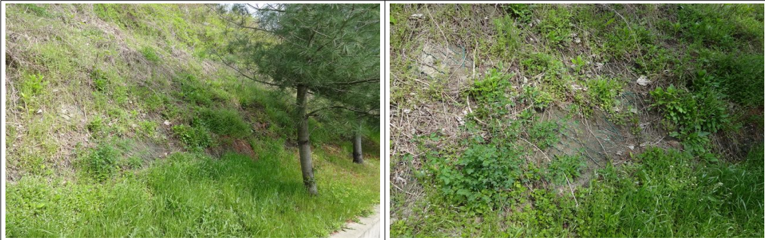
STA.0-20 1단 녹생토유실
