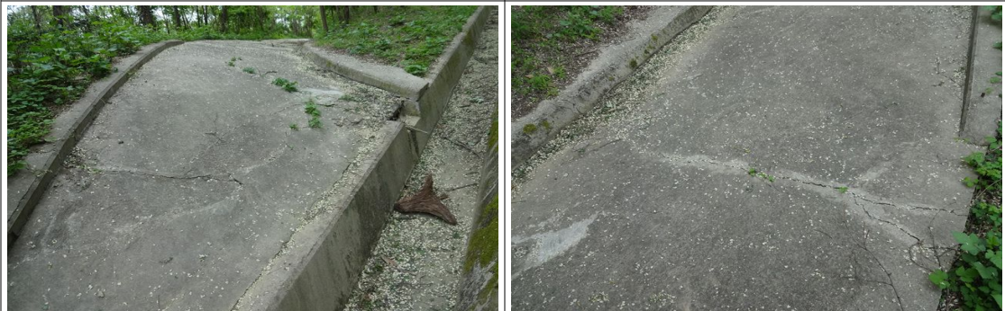
83.91K 1소단배수로 균열
