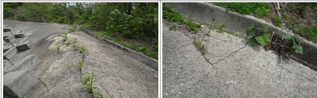
73.98K 6단 숏크리트 균열
