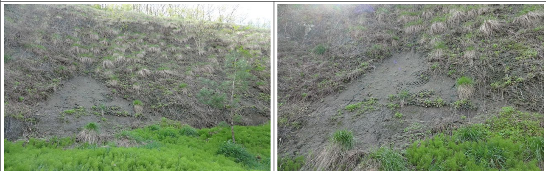
STA.0-20 1단 녹생토유실
