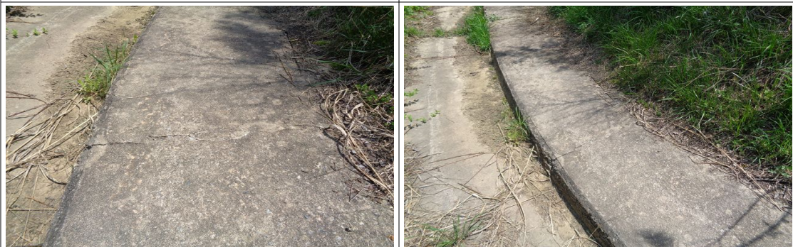
STA.0-33 2소단배수로 균열
