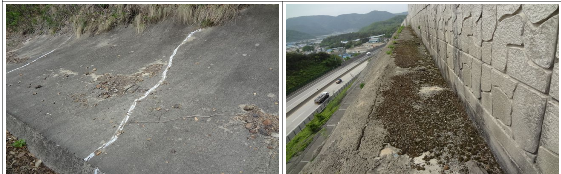
76.45K 산마루측구 균열
