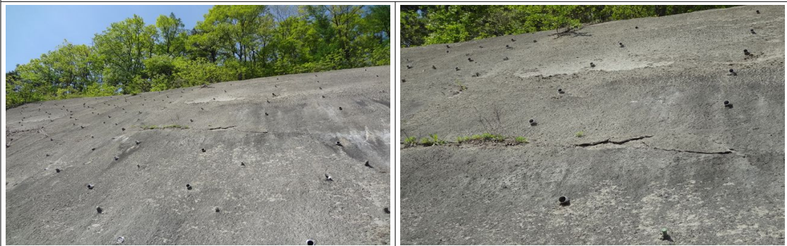
70.84K 4단 숏크리트 균열, 들뜸
