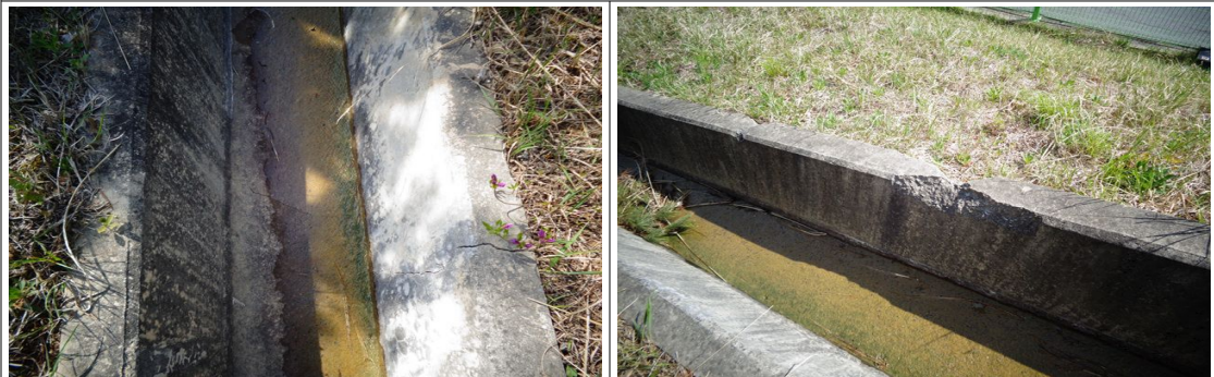
46.73K 산마루측구 균열
