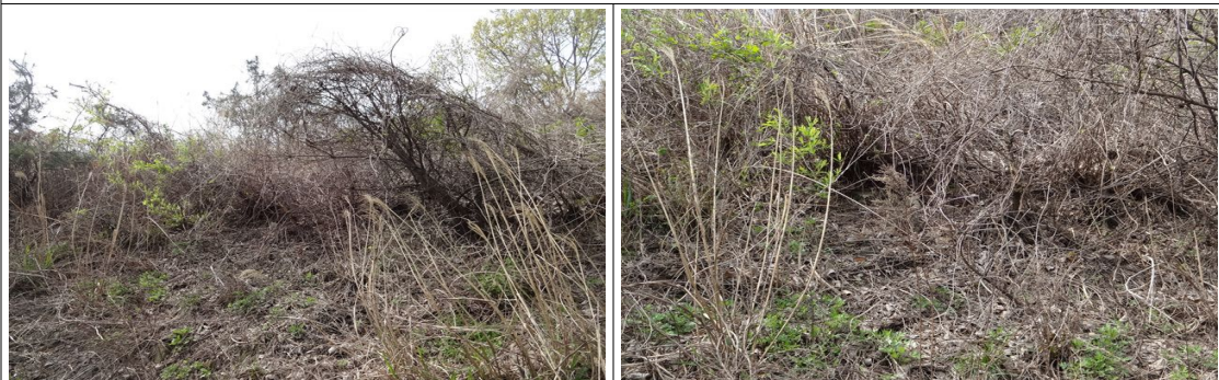
STA.23+060 2단 표층유실
