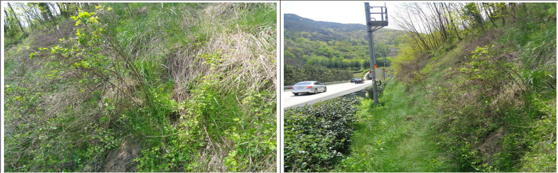
STA.41+420 1단 토사유실
