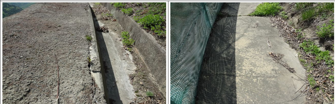
70.90K 4단 숏크리트 균열, 들뜸
