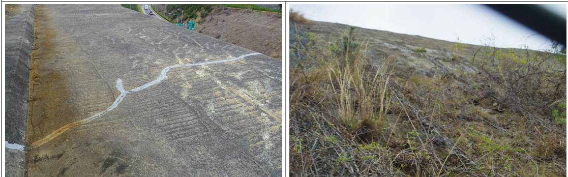
10.88K 1소단배수로 균열
