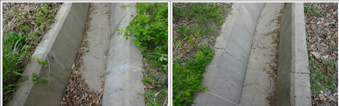
STA.0-30 측구 균열
