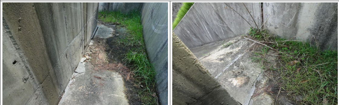
STA.0-20 1단 갯문배면배수로 파손
