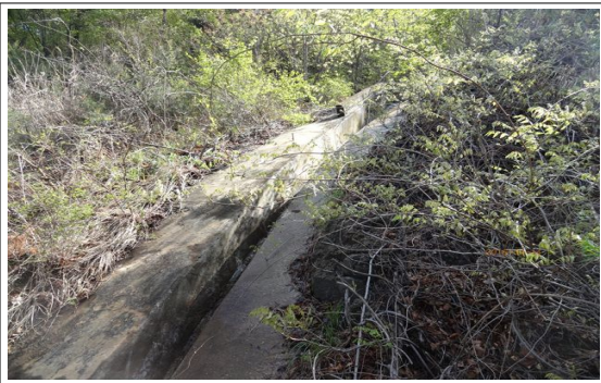
STA.0+090 1단 절리부 누수
