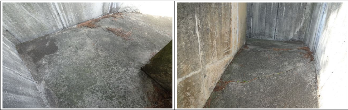
STA.0+20 1단 갯문배면배수로 균열
