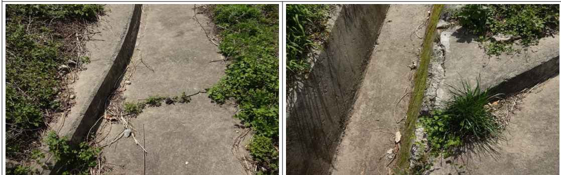
49.95K 1소단배수로 균열
