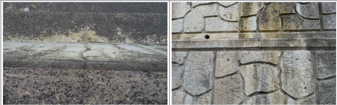
10.87K 1단 옹벽 균열
