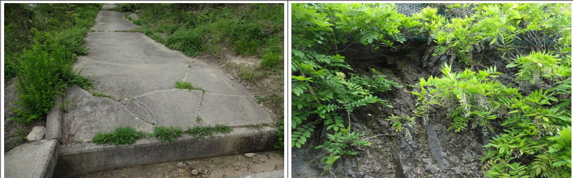
83.69K 1소단배수로 균열
