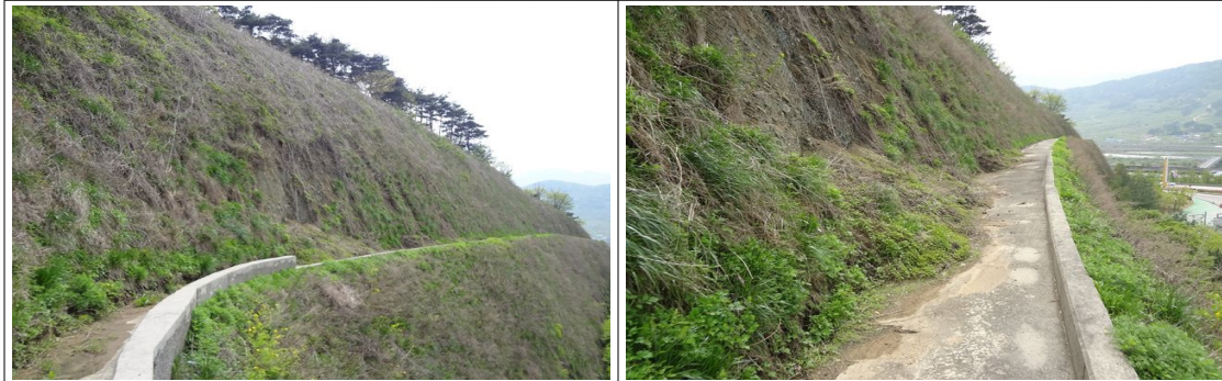
(3/3) STA.0+30 2단 녹생토유실
