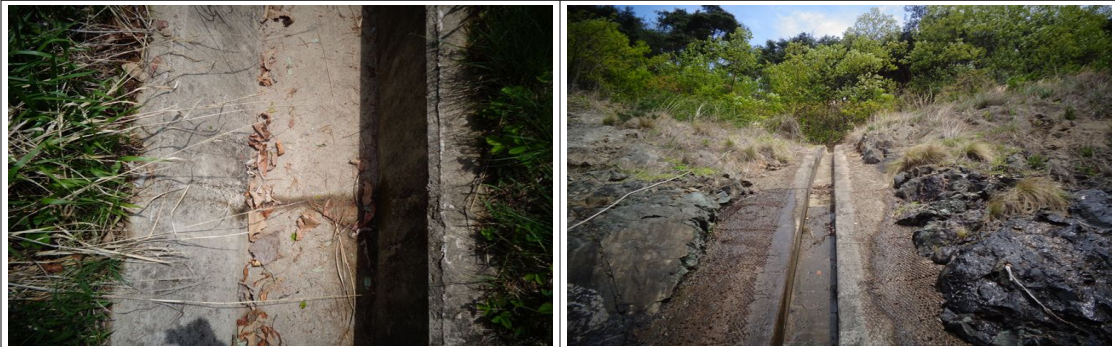
27.09K 산마루측구 균열
