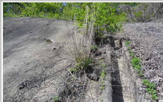
70.77K 2단 슛크리트 파손
