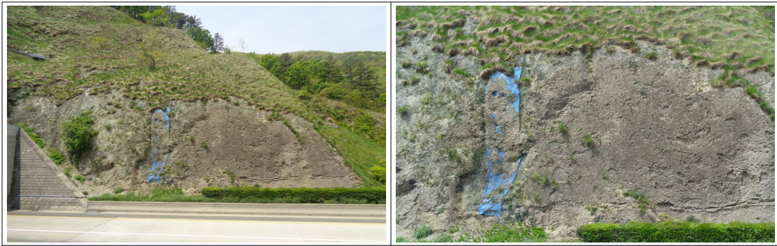
STA.0-5 1단 녹생토유실 20.0*10.0
