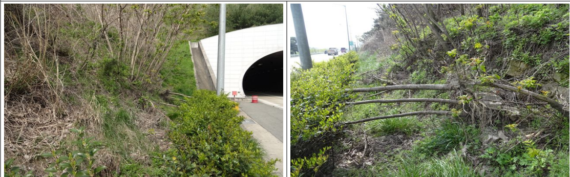
STA.23+060 1단 녹생토유실
