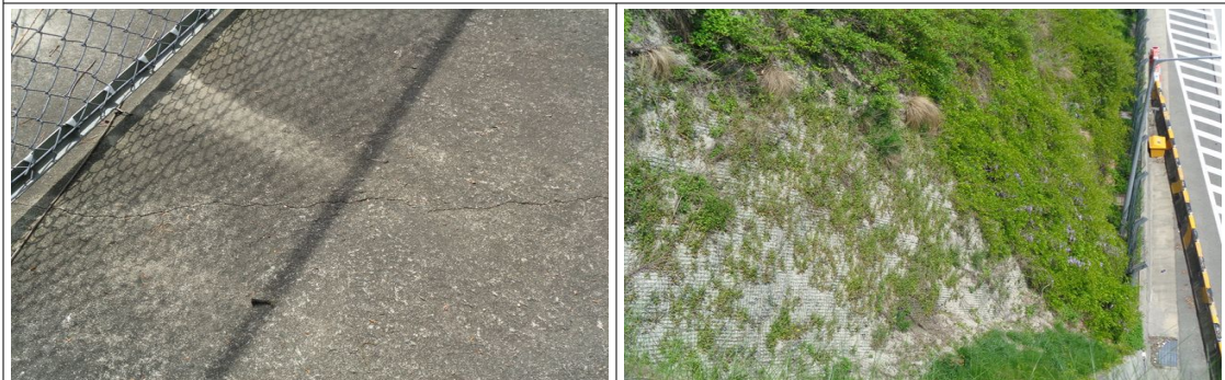
STA.60+278 1소단배수로 균열 0.3/2.0
