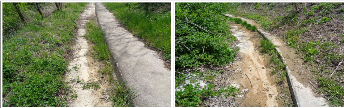
STA.0-15 2소단배수로 토사퇴적
