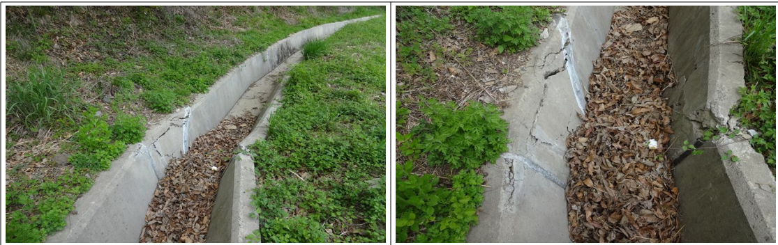
STA.00-30 측구 파손
