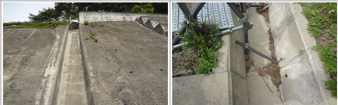
76.55K 2단 슛크리트 균열
