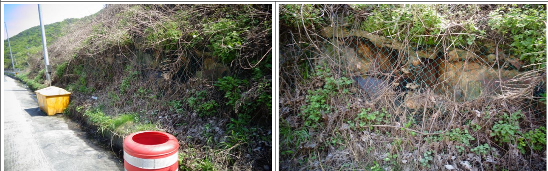
STA.0+90 1단 녹생토유실
