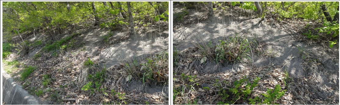
STA.0+60 자연사면 표층유실
