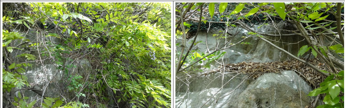
72.92K 1단 슛크리트 내부 토사유실
