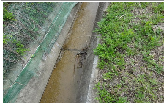
(2/3) STA.0+40 산마루측구 실란트 파손
