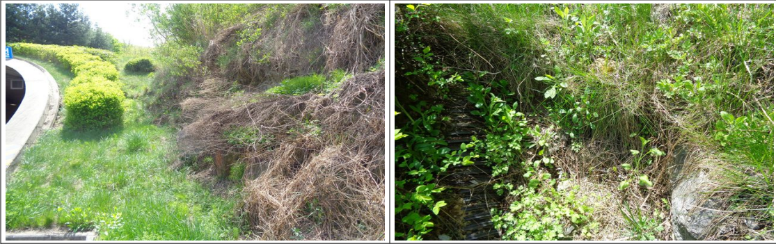
STA.41+380 1단 세굴
