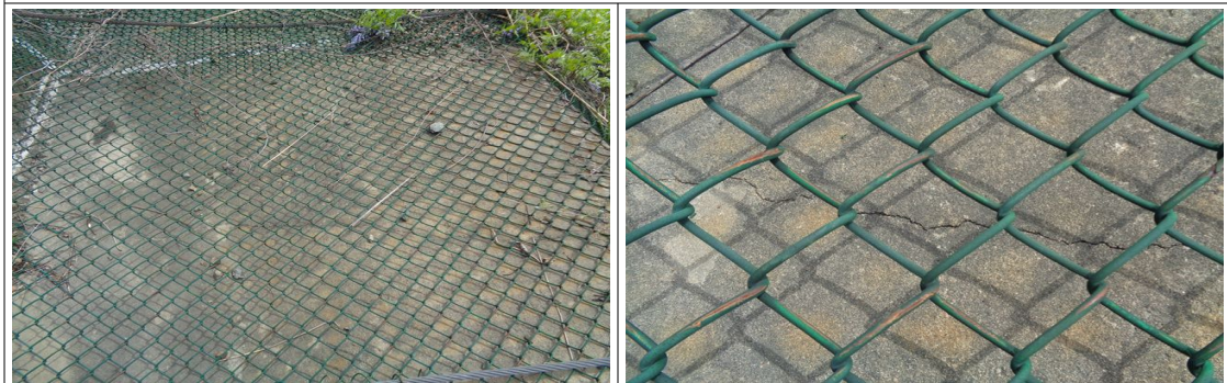
72.90K 1소단배수로 균열
