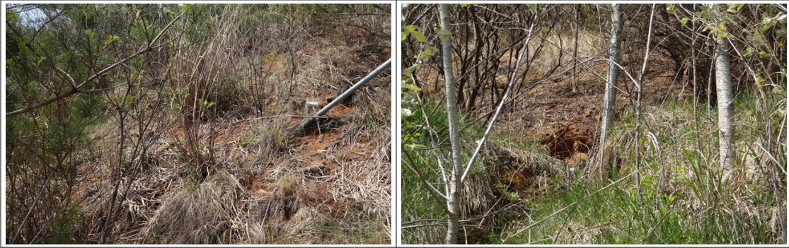
우측사면 STA.38+540 5~7단 표층유실 및 세굴
