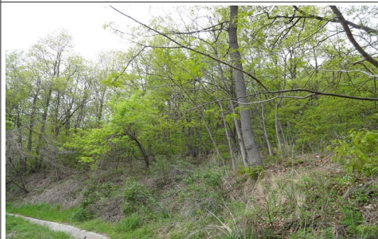
STA.0+20 자연사면 수목전도위험
