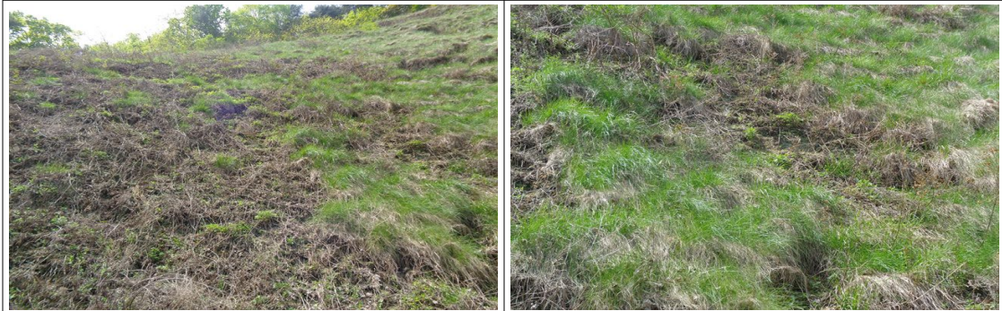
STA.0-5 2단 녹생토유실 1.0*1.0
