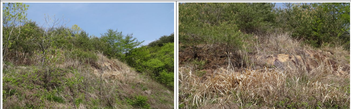
우측사면 STA.38+580 6단 표층유실
