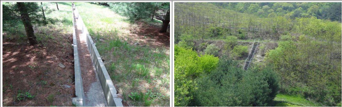
STA.0-20 1단 뒷채움유실
