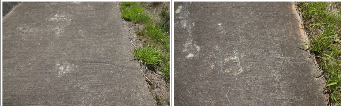
28.95K 1소단배수로 균열
