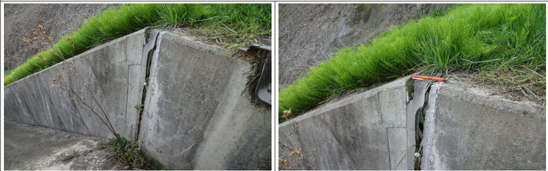
STA.0-20 1단 갯문배면배수로 균열
