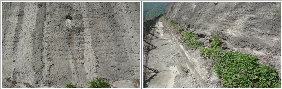
70.90K 3단 숏크리트 균열, 하부 들뜸
