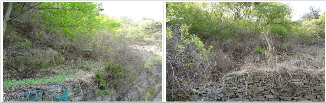
STA.0+35 자연사면 유실우려
