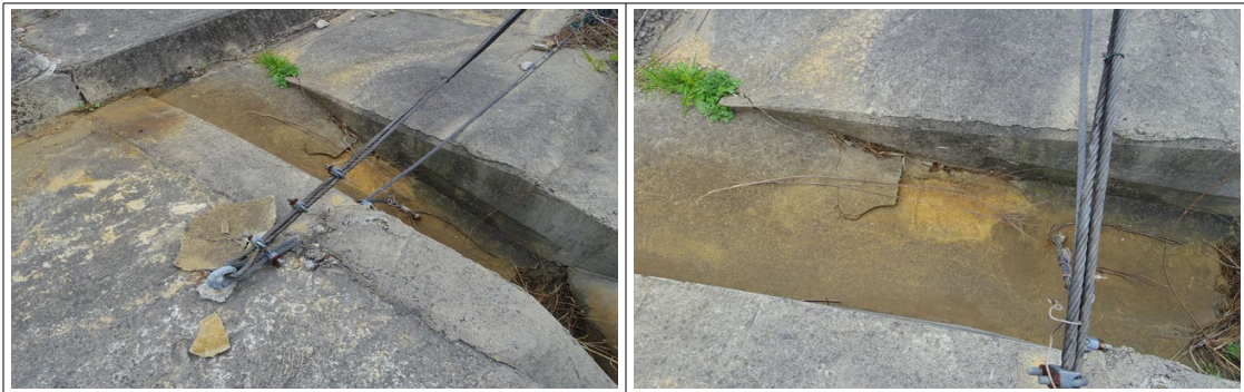
10.86K 1단 배수로 파손
