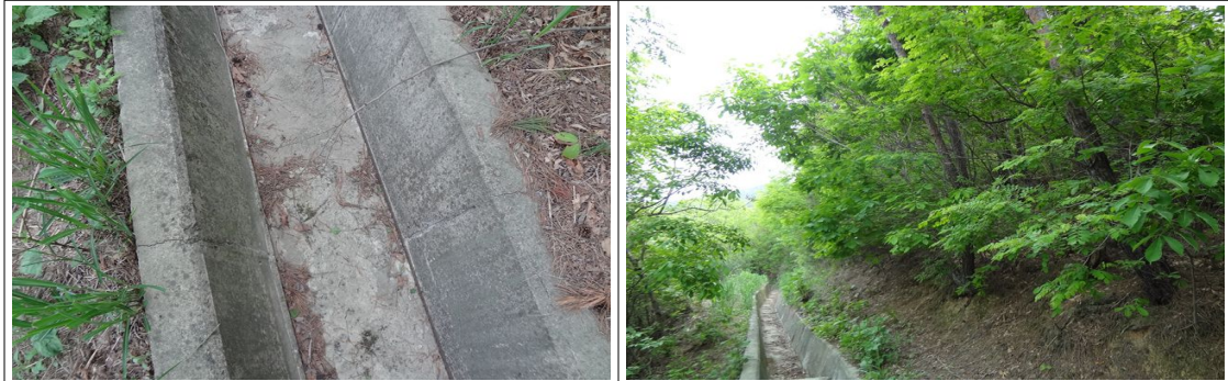
78.19K 산마루측구 균열
